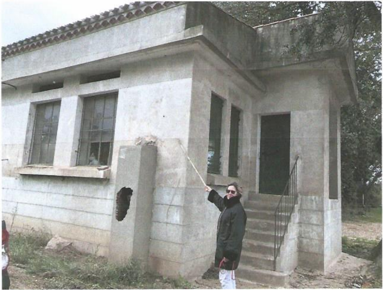
Niveau atteint par l'eau le 15 octobre 2018
